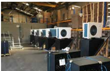
In onze werkplaats vindt het aansluiten van de warmtepompen plaats.
